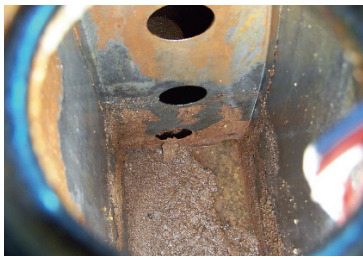
Die Rostumwandler-Kur (Mischung bis 1:60 mit Wasser) hat nicht allen Belag...
